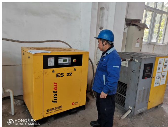
设备管理部技术人员正在查看空气压缩机运转情况
